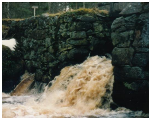
Ovan: högt vattenstånd 1986 Till höger: hålet längre ner på dammväggen 2013 och längst till höger 2019
